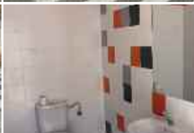
Nuevos baños en colegio Carlos Ruiz y rehabilitación de los del José Jalón.
